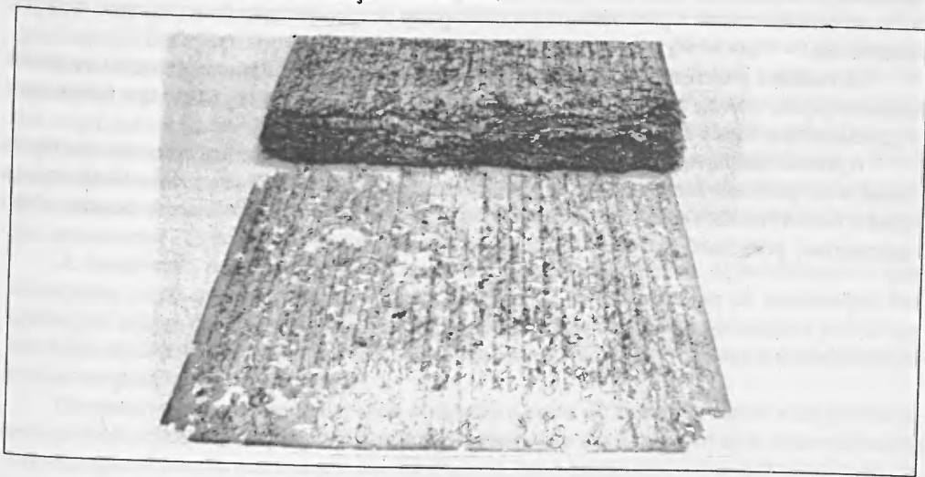
Danos causados por coleópteros (brocas)
